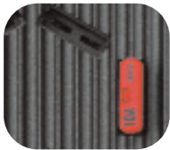
Notfunktion durch Umstecken des Sicherungsautomaten
